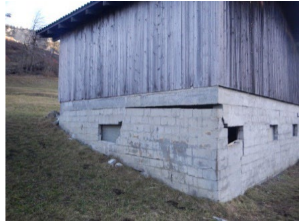
Abbildung 44. Schäden am Fundament eines Stalls infolge differentieller Deformationen.
